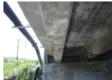
写真-2. 宮下橋損傷状況(補修後)
