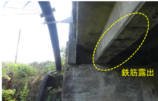
写真-1. 宮下橋損傷状況(補修前)
